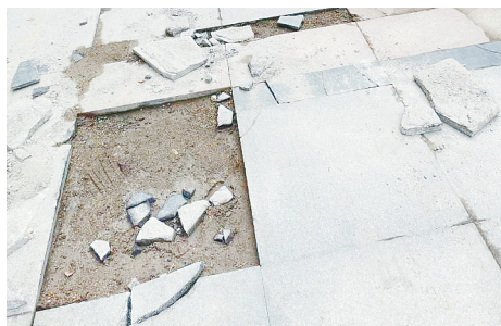
兰乔迪亚小区西门北边路面毁损严重。
