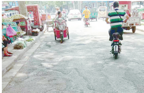
民主路与五一路交叉口，路面凹凸不平。
