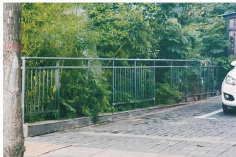
舟山路与淞江路交叉口东南角，绿化带围挡损坏。
