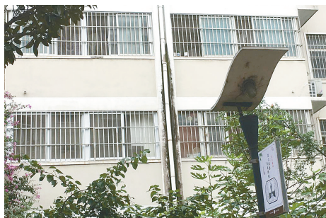
文化路祥和家园40号楼下水管破裂。
