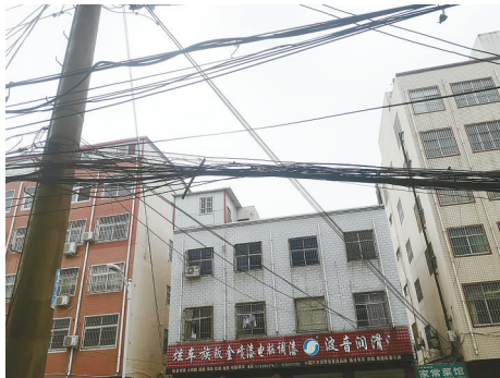
和平路与青河路交叉口东南角，线缆杂乱无章。
