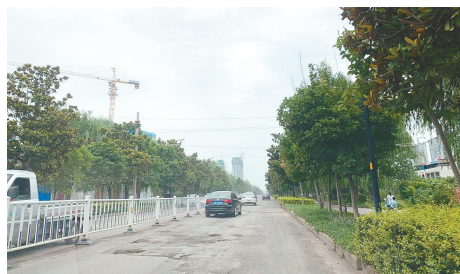
金江路东段，路面坑洼不平。
