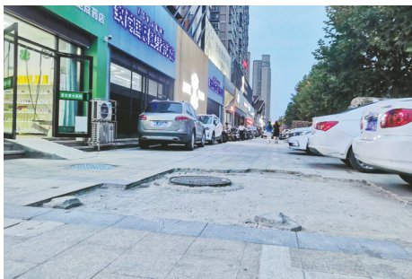
嫩江路与黄山路交叉口西南角，道路坑洼不平。
