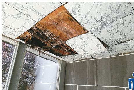
恒大名都小区北侧公厕内多处破损。
