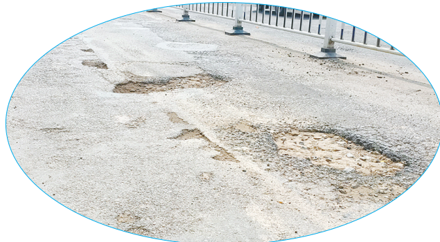
市区文化路与金江路交叉口附近路面坑洼不平。
