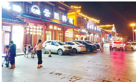
开源森林公园北门东侧人行道破损。
