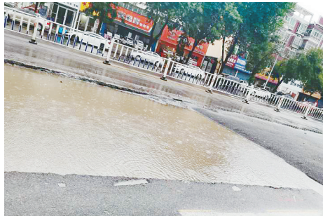
解放路与湘江路交叉口东200米，路面施工后留下大量坑洼。
