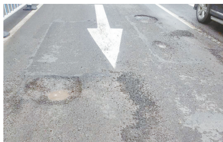
黄河路与泰山路交叉口附近路面坑洼不平。
