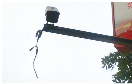
滦河路与韶山路交叉口路南监控线被剪断。
