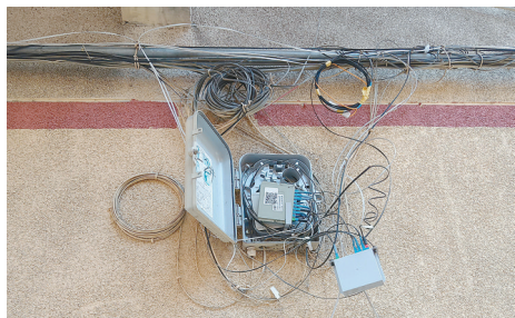
湘江路西段416号院，光纤线路凌乱。
