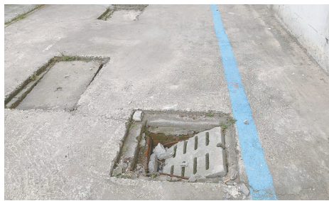
金华小区院内道路不平。
