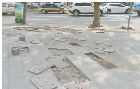
崂山路与海河路交叉口,路面破损。
