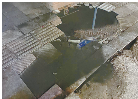
长江路源汇区政府对面污水横流。
