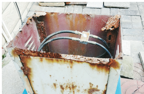
香榭里花园小区，有线电视交接箱损坏严重。
