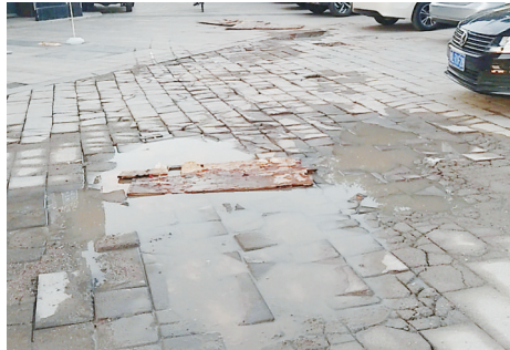
牡丹江路与黄山路交叉口西北角，人行道地砖破损。
