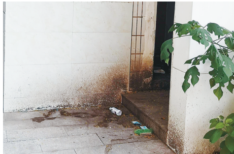
长江路金都大酒店东边一停业加油站公共卫生间卫生差。
