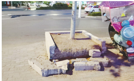
淞江路西段临近107国道北侧，幸福港项目部门前树木围挡破损。
