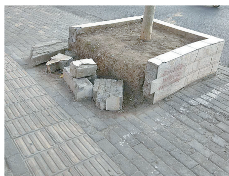
郾城区许洼小学东门外树围挡破损。
