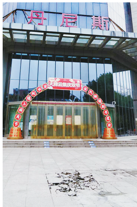
嵩山路与辽河路交叉口的丹尼斯门前，地面破损。
