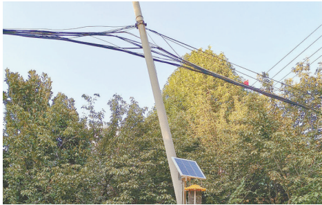
辽河路教育局家属院路口，一线杆倾斜，存在安全隐患。
