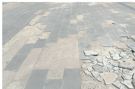
汇丰街与梅花山路交叉口东北角，地砖损坏严重。
