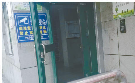
亚泰名仕公馆小区单元门不能关闭。
