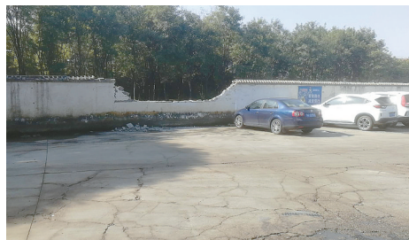
交通南路与南环辅路交叉口林地外围墙破损。
