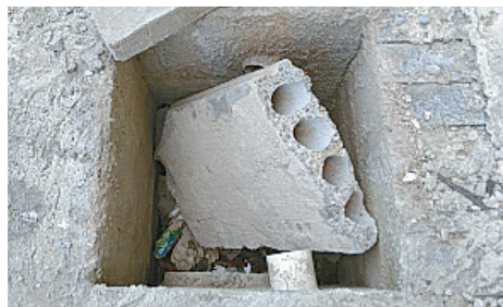
嫩江路与太白山北路交叉口附近一污水盖板下陷。
