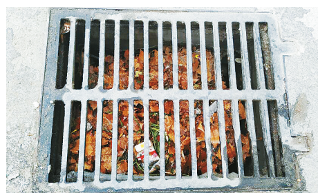
解放路与湘江路交叉路口路北,路边排水口里堆满落叶及垃圾。
