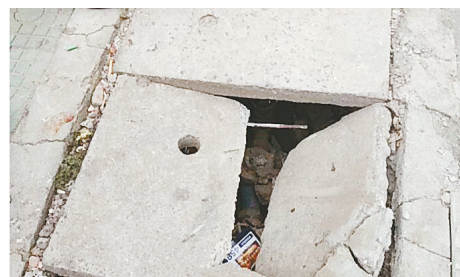
五一路与柳江路交叉向南约100米路西,新阿丽批发超市门前井盖破损。
