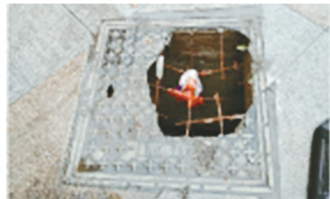
金山北路与黄河中路交叉口向南40米路西，雨水井盖破损。
