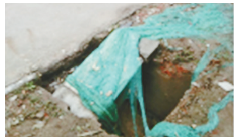
巴山路与海河路交叉口向南150米路西，路面破损。
