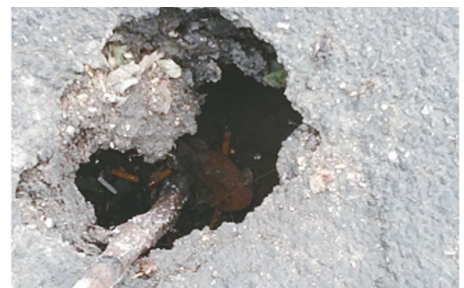
泰山南路与樟江西路交叉口向北60米路东，路面塌陷。
