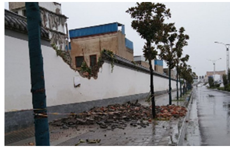
解放北路与黄河中路交叉口向北90米路东，围墙破损。
