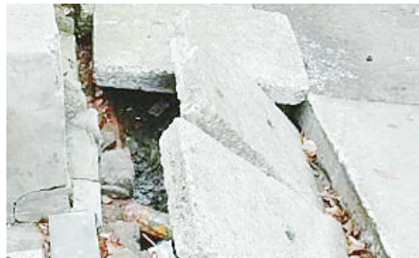
黄山路与黄河路交叉口向南约50米路西，污水沟盖板翘起。
