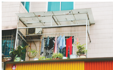
柳江西段柳江西区8号临街楼，有人私自搭建玻璃棚。
