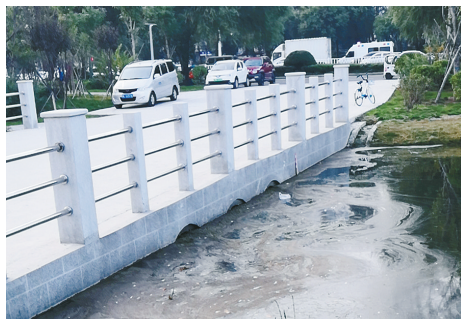
祁山路，幸福渠内垃圾漂浮，渠水浑浊。
