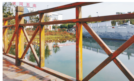
漯河五高门前西侧,幸福渠木桥护栏多处破损。
