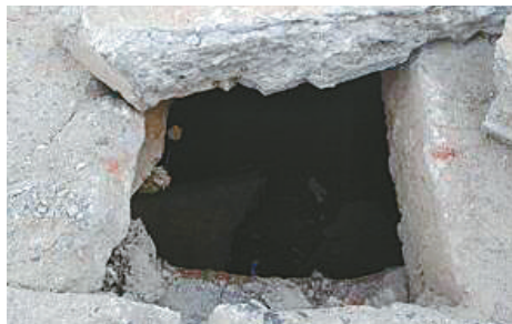
辽河路与井冈山路交叉口向东约30米路北，盖板破损。
