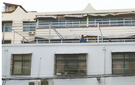
湘江路罐头家苑小区，有人在最后一栋楼的顶层私自加盖一层楼。
