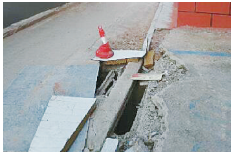
建设路豫苑小区8号楼一单元门口东侧，污水盖板破损。
