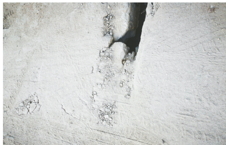
黄河路中段保险公司家属院，刚刚修补过的水泥地面就变成了沙土。
