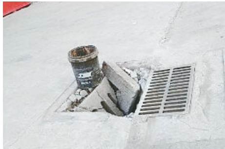
桂江路与白云山路交叉口向东约40米路南，博宇彩钢门前污水井盖破损。
