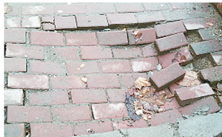
金江路与嵩山南路交叉口向东约100米路北，人行道路面塌陷。
