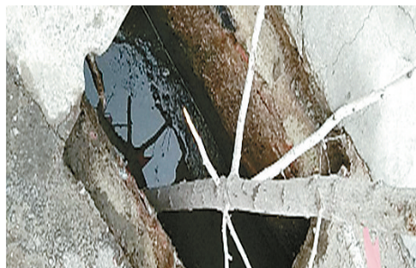
金山南路与滨河东路交叉口向南约100米路东，小李花卉门前污水盖板缺失。
