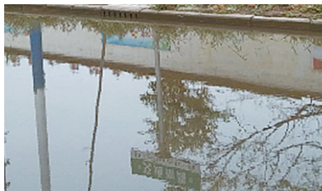
交通南路与樟江路交叉口北边下水道堵塞，路上有积水。
