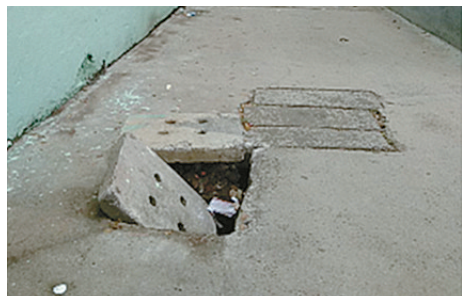
辽河路与舟山路交叉口向西约10米路北小路,污水盖板掉落、移位。
