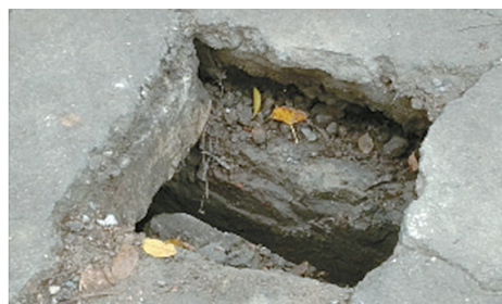
嵩山南路与金江路交叉口向北约70米路东,污水盖板破损。
