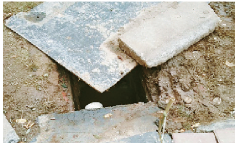
黄山路与淮河路交叉口附近，窞井没盖，用木板代替。
