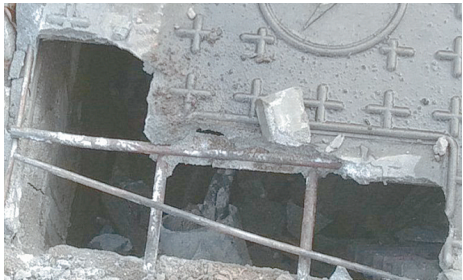
燕山北路与淞江路交叉口向南约10米路东，人行道井盖破损。
