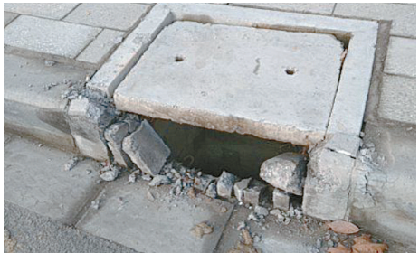
太白山北路与淞江路交叉口向南约120米路西，下水道口破损。
