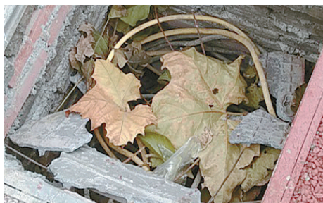
燕山南路与珠江路交叉口向南约200米路东,人行道路灯井盖破损。
