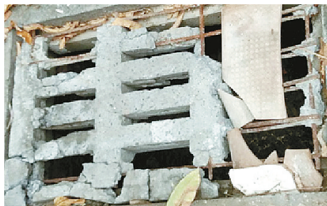
柳江东苑小区3号楼,雨水篦子破损。
