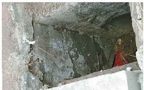
人民东路与庐山路交叉口向东约60米路北小路,污水井盖缺失。
