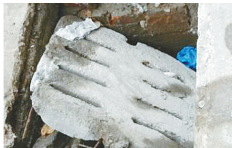
人民东路与纺织路交叉口向西约30米路北化肥厂家属院，窨井盖损坏。
