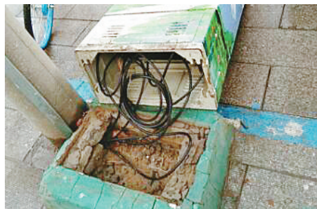
黄河路与邙山路交叉口附近，通讯交接箱（中国电信）倒地。
