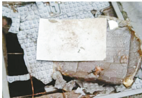
人民东路与燕山南路交叉口向西约120米路南，电力井盖破损。
