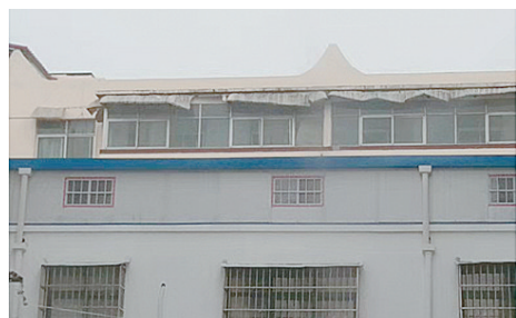
湘江路罐头家苑小区,有人在顶层私自加盖一层楼。
