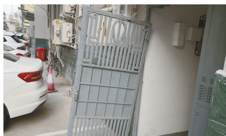
棉麻小区1号楼两个楼道单元门破坝。
