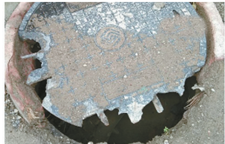
渭河路与中山北路交叉口向西约180米路南，通讯井盖破损。
