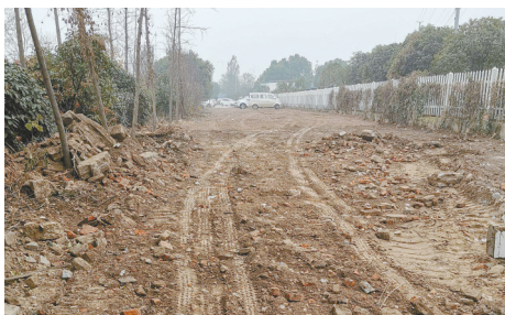
漯河优润食品有限公司门前，有人每天半夜偷偷施工，且地面未进行覆盖。
