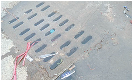
环城路与京华路交叉口向西约80米路北，下水管道堵塞。
