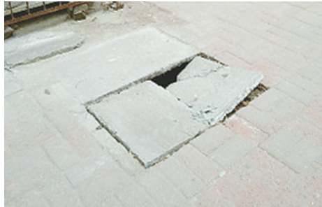
马路街与友爱街交叉口向东约180米路南，井盖破损。
