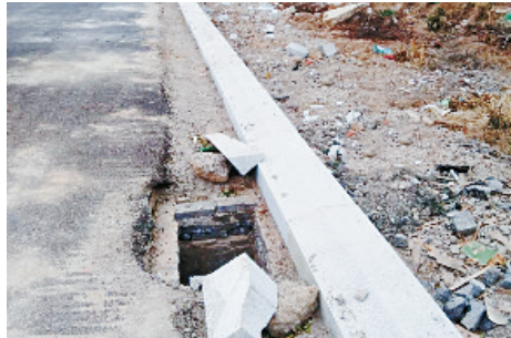
东山东路与湘江东路交叉口向北约100米路西，井盖缺失。
