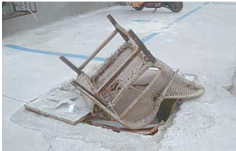
水利管理站家属院4号楼一单元东侧，污水盖缺失。
