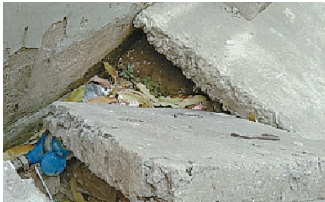
柳江路与柳江二巷交叉口向东约120米路南，井盖移位。
