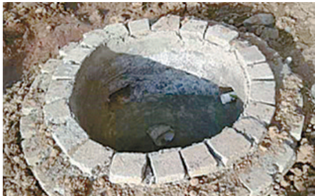
庐山路与珠江路交叉口向南约30米路东，井盖缺失。
