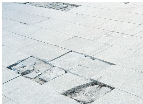
嵩山路沙河桥南边西侧路面破损。
