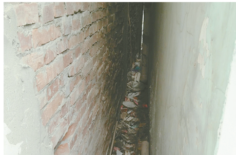
市司法局临街楼与垃圾中转站之间的墙缝里有好多垃圾。
