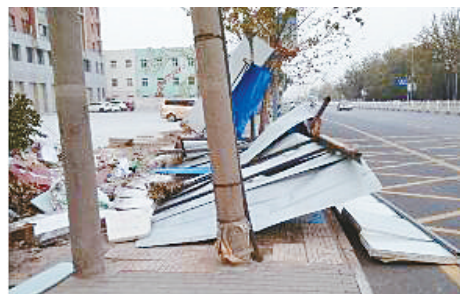
人民东路与燕山南路交叉口向东约220米路南,施工围挡倒地。
