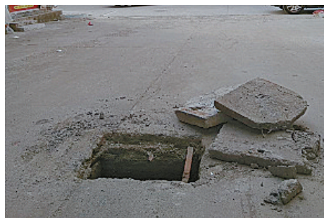
邛山路与辽河路交叉口向北约10米路西，井盖移位。
