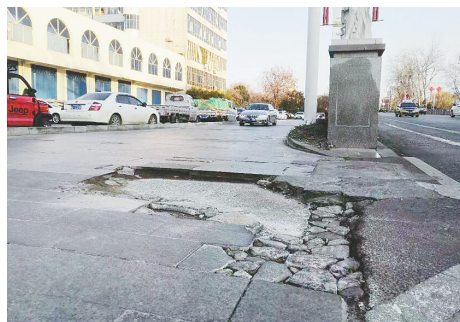
嵩山路沙河桥南西侧辅路,路面破损严重,影响车辆、居民通行。
