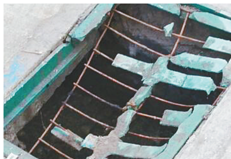
银鸽路与渭路交叉口向南约200米路西,小路向西约80米路北,雨水篦子破损。
