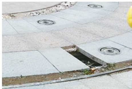
人民路与五一路交叉口向西约120米路南，盖板缺失。
