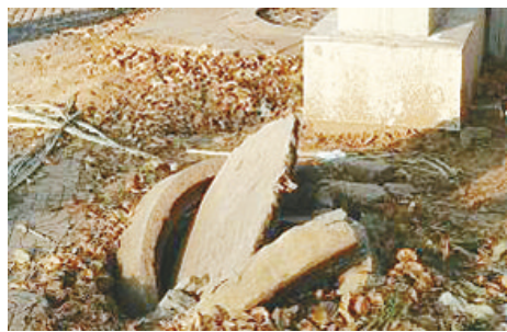
柳江路与嵩山路交叉口向东约30米路北，绿化带内污水井盖损坏。
