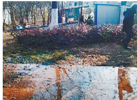
牡丹江路与燕山北路交叉口向西约70米路南，绿化带内自来水管破裂。
