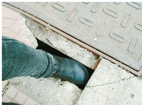
白云山路与柳江路交叉口向南约100米路东，人行道破损。
